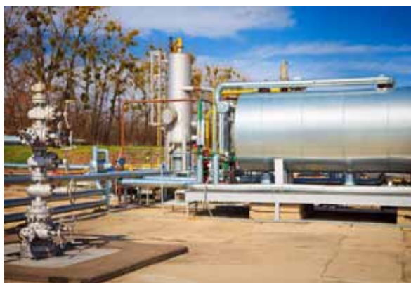
Těžba zemního plynu a ropy Břeclav, produkční kříž sondy, třířádkový separátor na ropu
